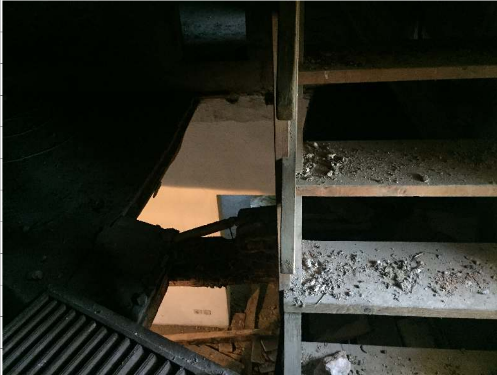
Foto 10-11 solaio tra piano terzo e quarto interessato da infiltrazioni e crolli
