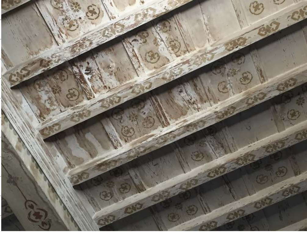
Foto 2-3 solaio tra piano primo e terzo interessato da infiltrazioni
