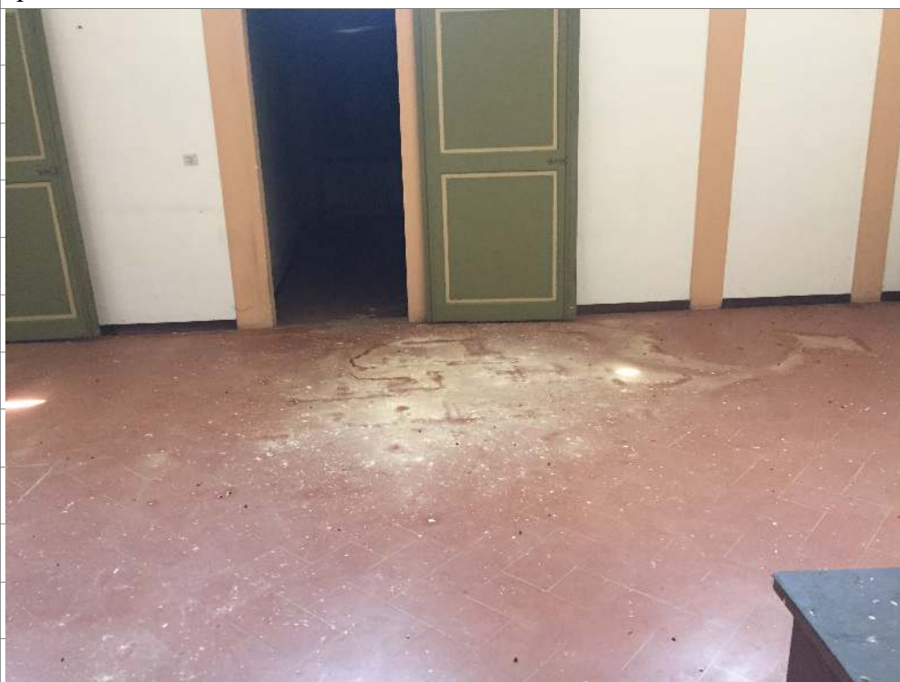
Foto 1 dei locali posti al piano primo interessati da infiltrazioni
